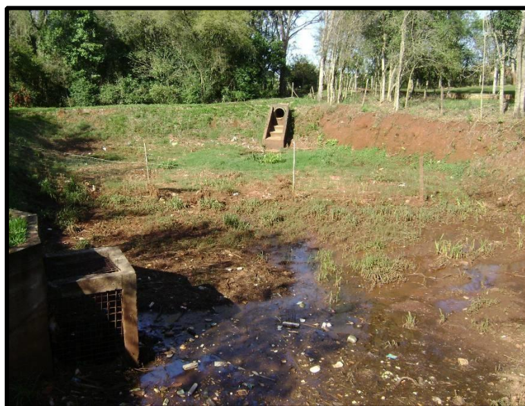
Figura 04 – Bacia de detenção
